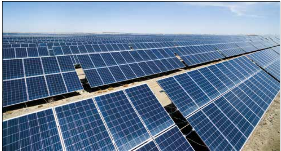
Champ de panneaux solaires
